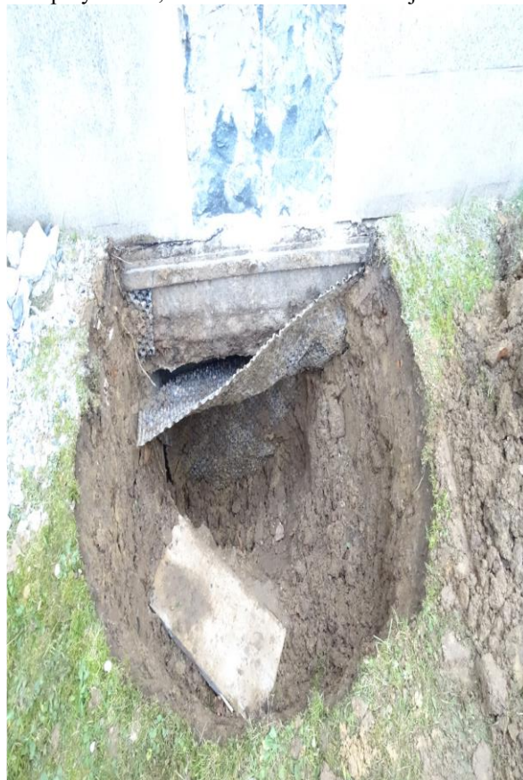
Łańcut, kościół, cokół w przyziemiu, stan w trakcie konserwacji. Autor fot. Jerzy Śliwa, grudzień 2017 r.
